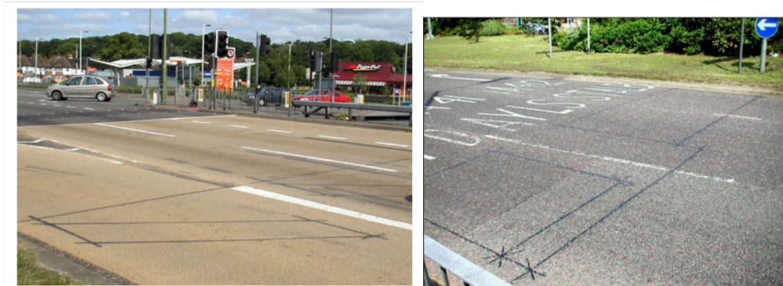
Figura 21 – Bucle inductive instalate în asfalt (exemplu)
